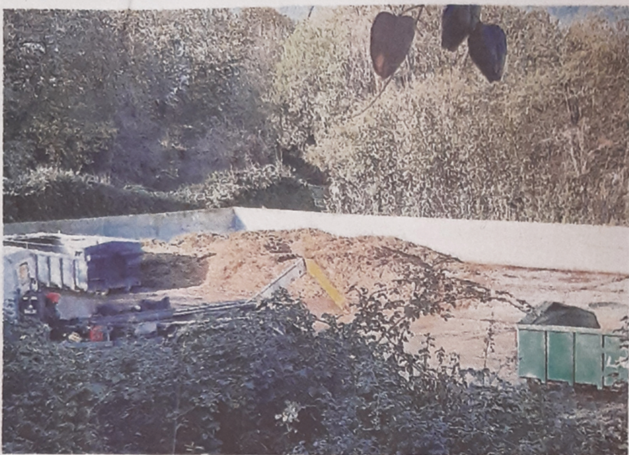
Une aire de stockage des matières stercoraires et des boues, sur le site Elivia au Lion-d'Angers.
