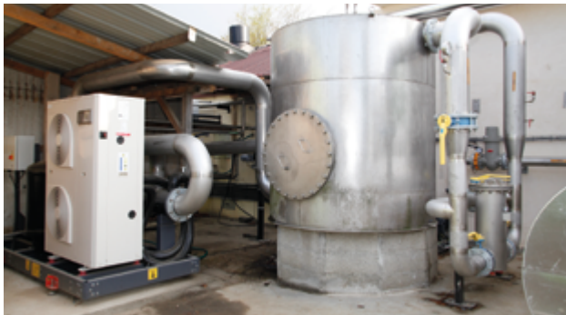
Unité de prétraitement du biogaz brut
