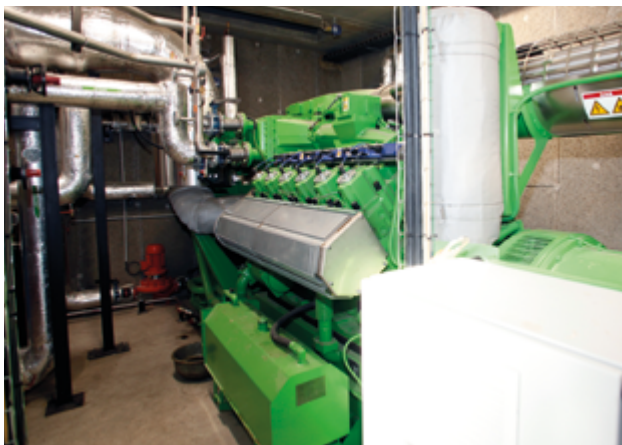
Unité de cogénération du biogaz brut prétraité
