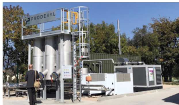
Unité d'épuration du biogaz brut prétraité
