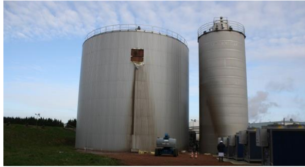
Détérioration d'un digesteur par la corrosion (source : DREAL)
